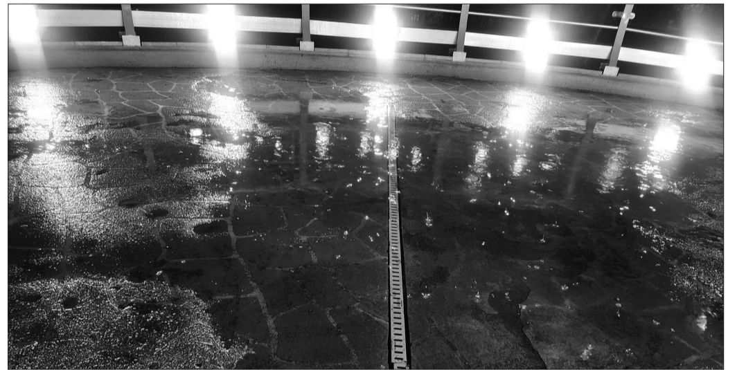
오름교 보수 공사 후 배수로 근처에 물이 고여 있다.
